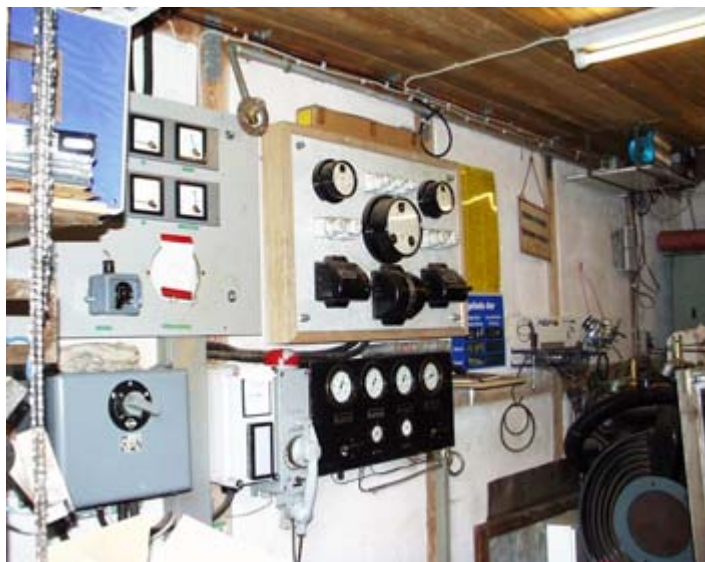
Neuere und alte Schalttafel in der Werkstatt
